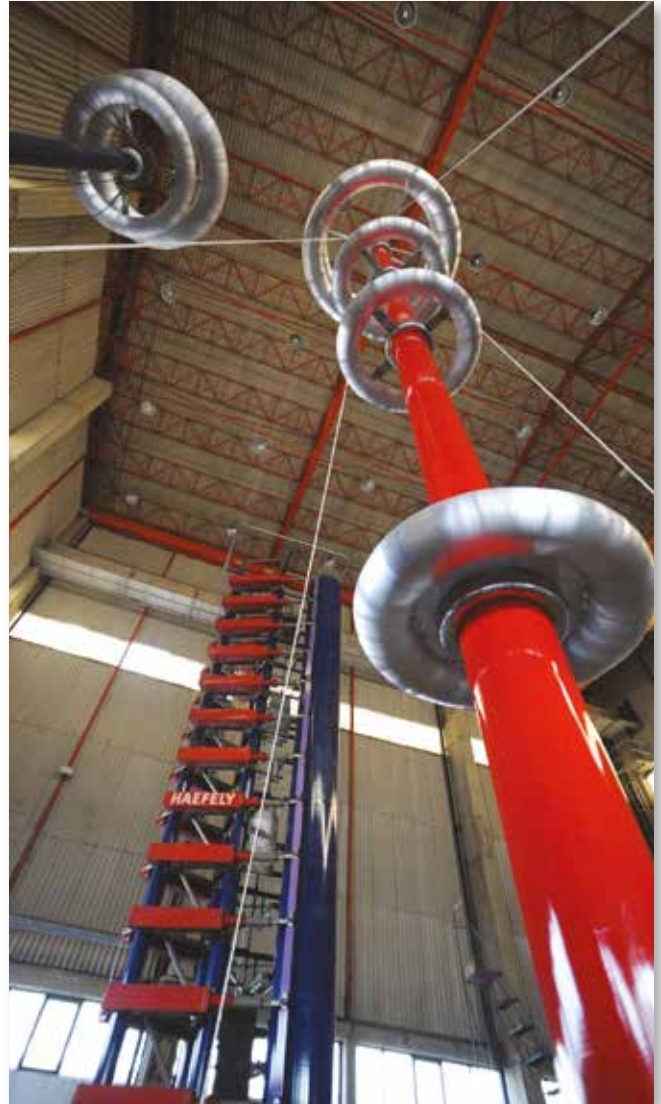
Yıldırım darbe jeneratörü gerilim bölücü.
