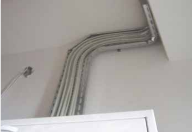
Kablolar bina içerisinde tek bir kanala döşenirler.
